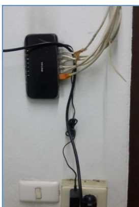
ภาพที่ 64 อุปกรณ์ห้องไฟฟ้าชั้น 3 ที่มา : ภาพอุปกรณ์เครือข่าย วันที่ 10 สิงหาคม 2560
