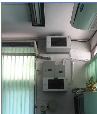
ภาพที่ 137 อุปกรณ์อาคารสำนักศิลปะและวัฒนธรรม(ส่วนวังจันทน์) ที่มา : ภาพอุปกรณ์เครือข่าย วันที่ 19 สิงหาคม 2560
