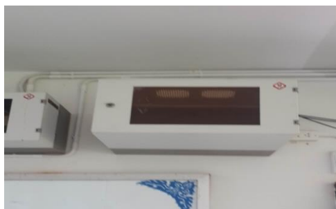
ภาพที่ 40 อุปกรณ์ตู้เครือข่ายอาคาร4
