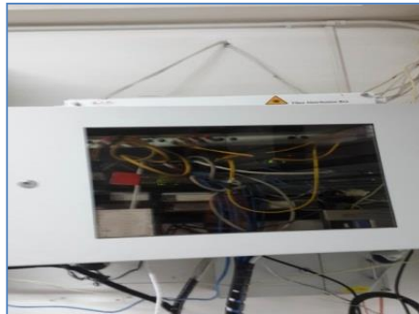
ภาพที่ 52 อุปกรณ์ตู้เครือข่ายอาคารวิทยสโมสร (ห้องธุรการชั้น1) ที่มา : ภาพผลการเก็บข้อมูล วันที่ 10 สิงหาคม 2560
