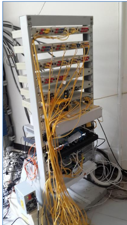
ภาพที่ 84 อุปกรณ์โหนดอาคารเฉลิมพระเกียรติ (อาคารเรียนรวม) ที่มา : ภาพผลทดสอบความเร็ว วันที่ 14 สิงหาคม 2560
