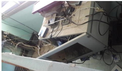
ภาพที่ 39 อุปกรณ์ห้องสมุดอาคาร2
