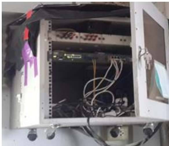
ภาพที่ 90 อุปกรณ์ชั้น 2 ห้องพักอาจารย์ ที่มา : ภาพอุปกรณ์เครือข่าย วันที่ 16 สิงหาคม 2560
