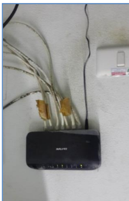
ภาพที่ 63 อุปกรณ์ห้องไฟฟ้าชั้น 2 ที่มา : ภาพอุปกรณ์เครือข่าย วันที่ 10 สิงหาคม 256
