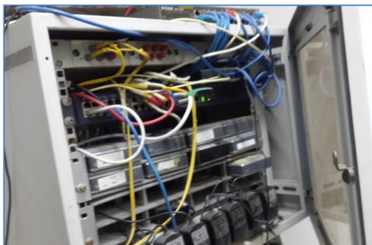
ภาพที่ 121 อุปกรณ์ห้องไฟฟ้าชั้น 1 สถาบันวิจัยและพัฒนา ที่มา : ภาพผลการเก็บข้อมูลตู้อุปกรณ์ วันที่ 19 สิงหาคม 2560
