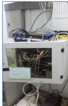
ภาพที่ 61 อุปกรณ์เครือข่ายห้องไฟฟ้าชั้น 1 ที่มา : ภาพอุปกรณ์เครือข่าย วันที่ 10 สิงหาคม 2560
