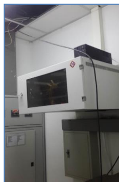
ภาพที่ 62 อุปกรณ์ห้องไฟฟ้าชั้น 1 ที่มา : ภาพผลการเก็บข้อมูล วันที่ 10 สิงหาคม 2560
